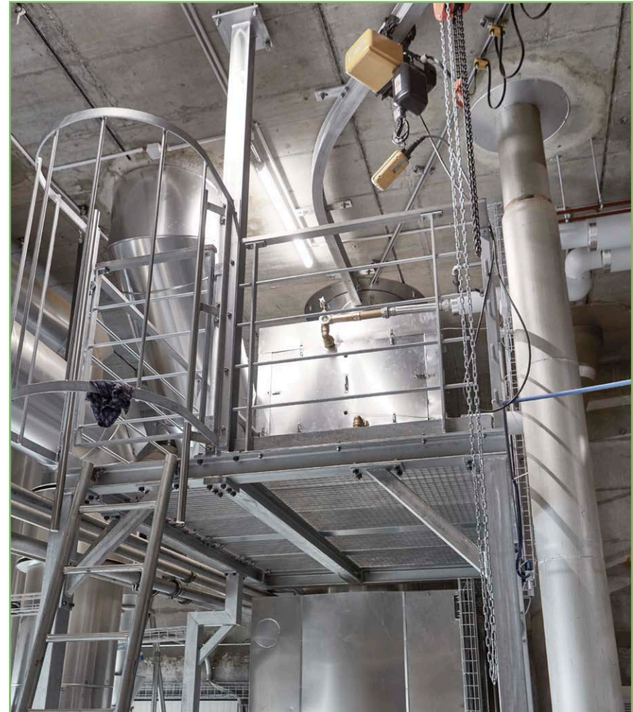
Wärmerückgewinnungsanlage am Produktionsstandort in Bern (Photoarchiv Blaser-Gruppe)
