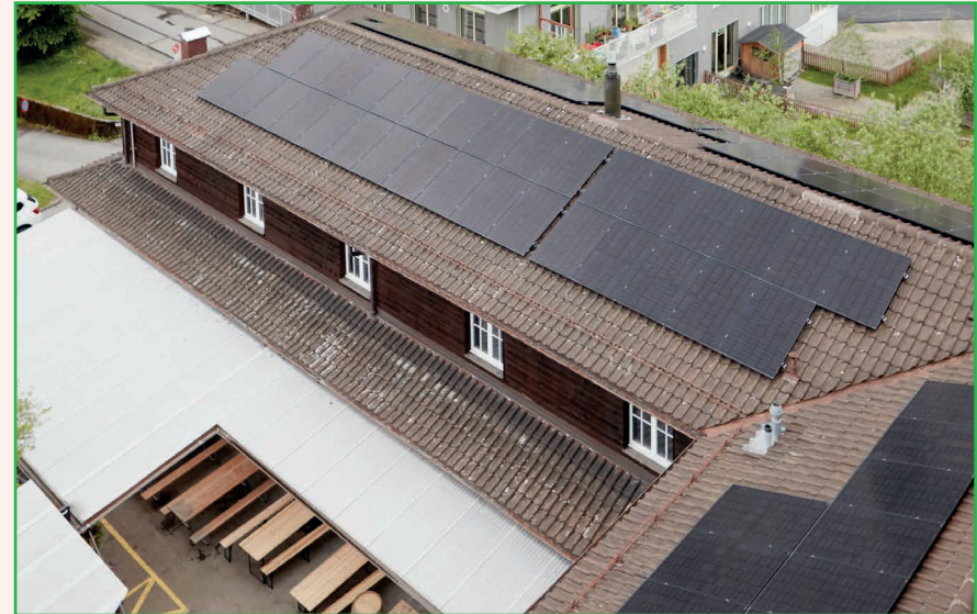
Photovoltaikanlage am Produktionsstandort in Bern (Photoarchiv Blaser-Gruppe)
