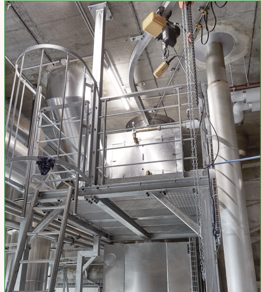
Wärmerückgewinnungsanlage am Produktionsstandort in Bern (Photoarchiv Blaser-Gruppe)
